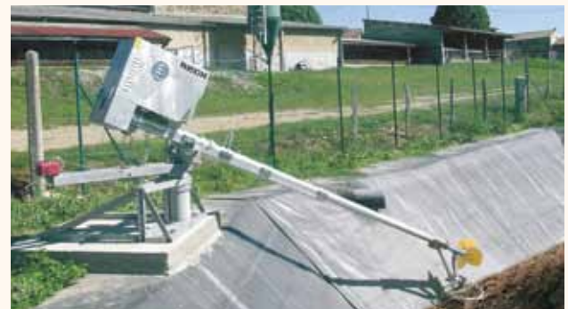
Diese Stationärbefestigung eignet sich besonders für große Güllelagerstätten wie Lagunen. (Abb.: ETR-SAB)
